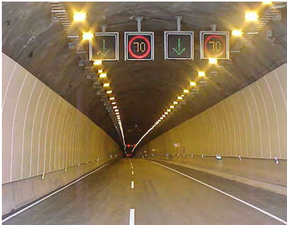
Figura 5.404- 02 Ejemplo de aplicación de señalización variable
